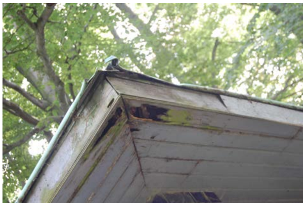
sanierungsbedürftiges Dach (Pumphaus)
