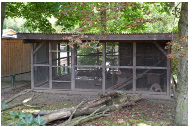
notwendige Instandsetzung/Sanierung der Gehege
