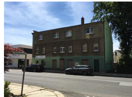
Sanierungsbedarf Hohensteiner Straße
