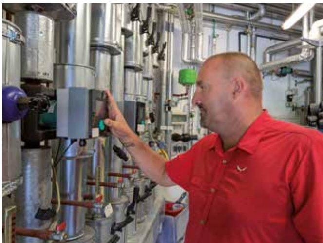
Dirk Schuler, Leiter des Eigenbetriebes Städtische Bäder, prüft die Heizanlage auf Funktionalität.
